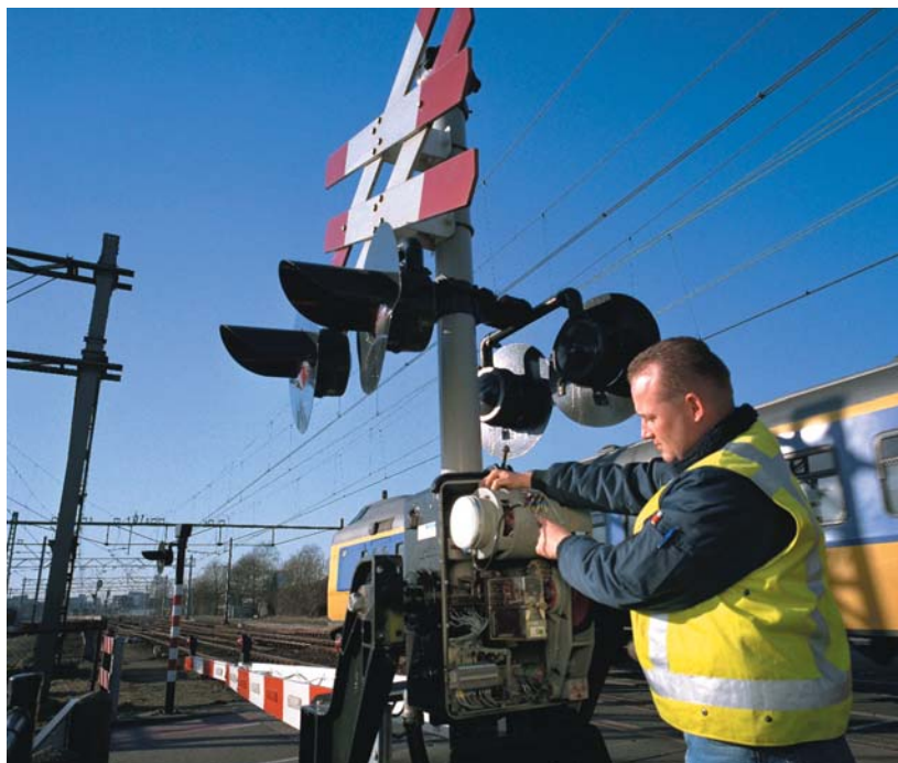
Het op locatie oplossen van een storing
